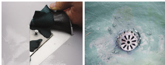
〈사진 2-11〉 고정철물 돌출 〈사진 2-12〉 드레인부 주변 들뜸, 손상
