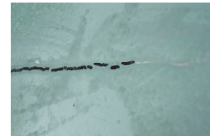
<사진 2-1> 방수층 균열(균열 거동 동시파단)
