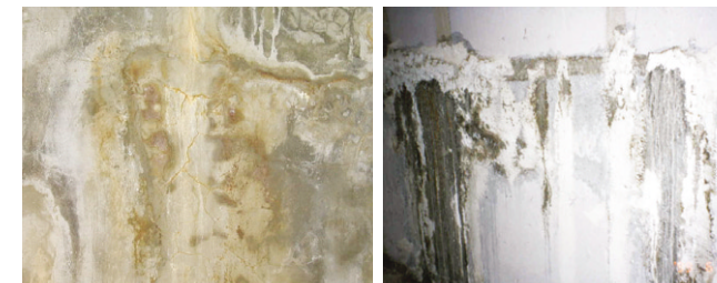
〈사진 2-19〉 누수 〈사진 2-20〉 누수부위 백화현상
