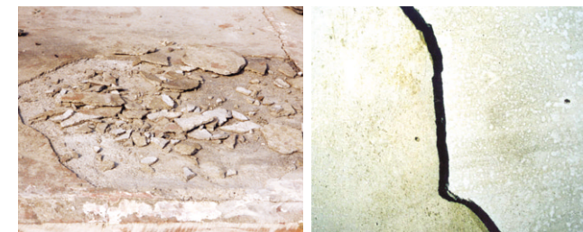
〈사진 2-17〉 방수층 들뜸 〈사진 2-18〉 균열/박리/박락
