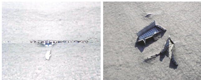
〈사진 2-9〉 시트 접합부의 방수층 파단 〈사진 2-10〉 시트 도막 적층부 박리
