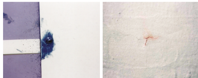
〈사진 2-15〉 고정철물 시공 불량 〈사진 2-16〉 금속판 부식 발생
