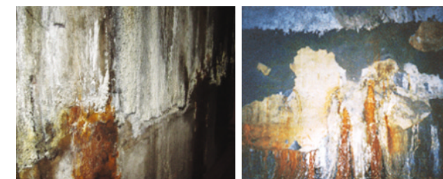
(a) 구조체 침식 (b) 보호막감재의 탈락
