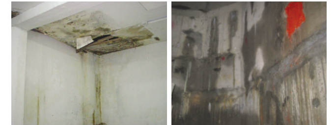
(e) 건축 지붕 누수 (f) 지하 외벽
